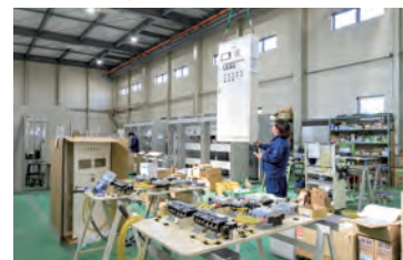
天井走行クレーンで運搬します
